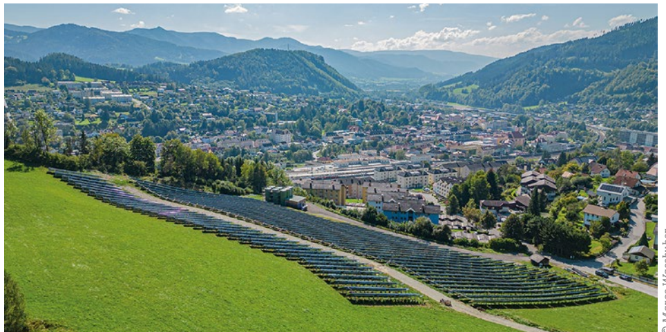
Die neue Solarthermie-Anlage auf der Mayerhoferwiese über der Stadt Mürzzuschlag
