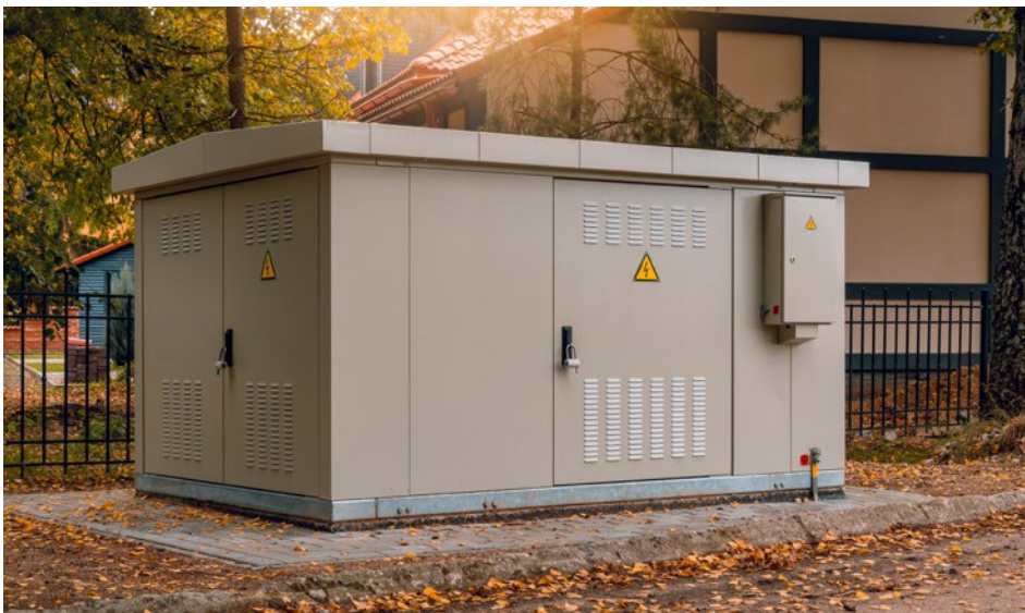
Recht unscheinbar, aber immens wichtig: Der Neubau und die Renovierung von Transformatorstationen – wichtige Teilschritte auf dem Weg zum Stromnetz der Zukunft
