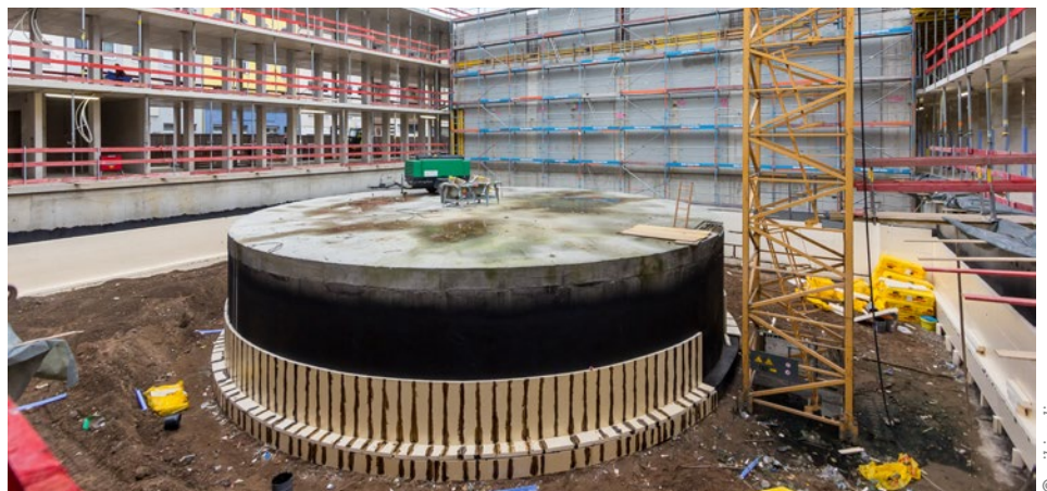
Das Prinzip, Energie mittels Eis zu speichern, sieht auf den ersten Blick unlogisch aus – aber es funktioniert: Hier ein Eisspeicher im Neubau des Historischen Archivs der Stadt Köln
